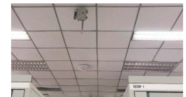
Instalación de la estación base UWB
